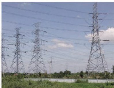
เสาไฟฟ้า
