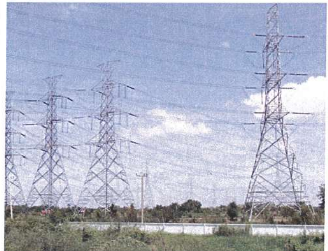
เสาไฟฟ้า
