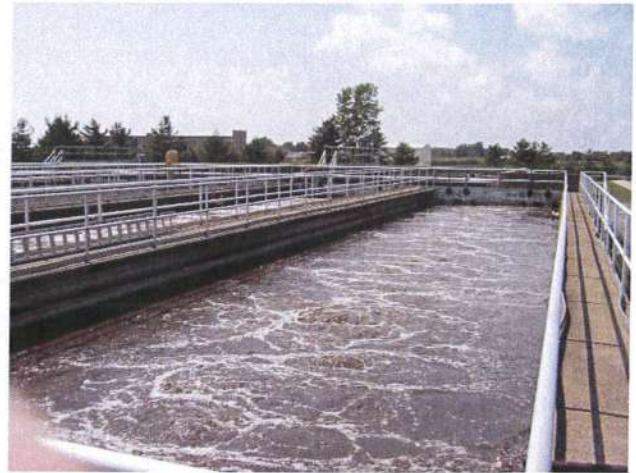
บ่อบำบัดน้ำเสีย
